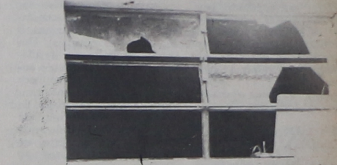
Ladrões danificaram as janelas do prédio
