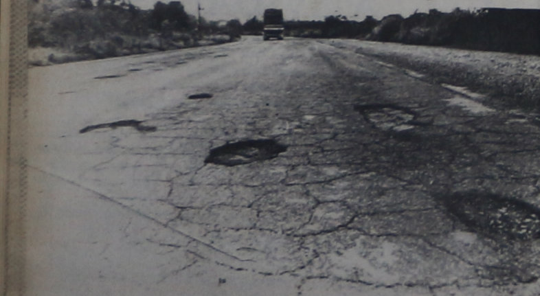
Os buracos na pista são inúmeros e perigosos
