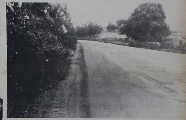
Nas curvas, o perigo aumenta devido às falhas na construção
