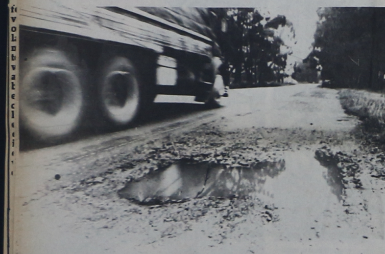
Há buracos nos acostamentos capazes de quebrar rodas e eixos quando não percebidos
