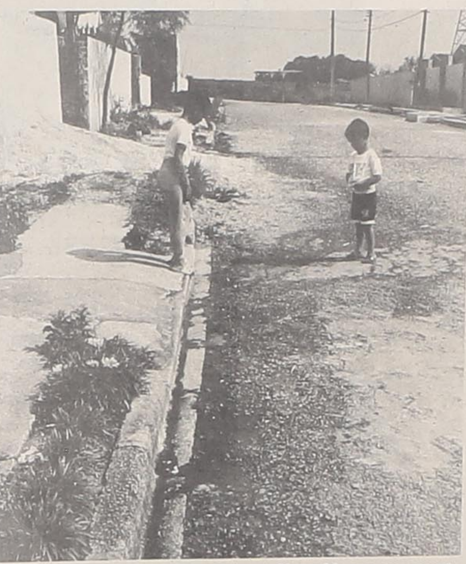
Em frente ao nº 16 da Rua Edgard Marochi, um vazamento transformou a rua num rio de detritos
