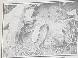
Tampa estourada provocando o vazamento
