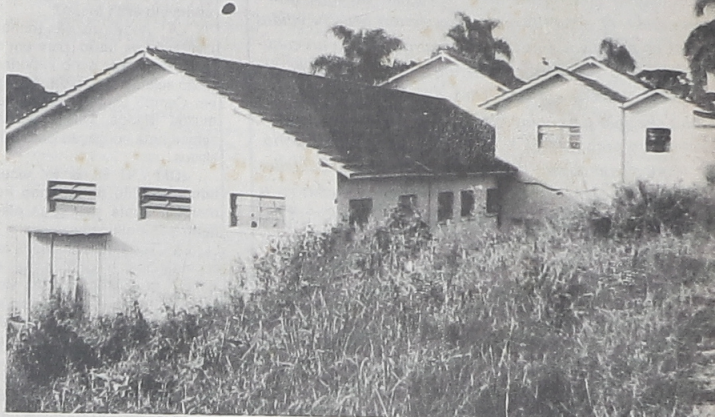
Situação precária do prédio da Guarda Mirim
