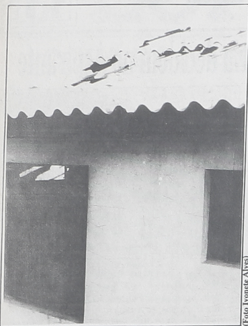
O fogo chegou a estourar algumas telhas da residência
