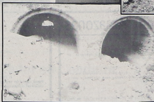
Situação da antiga canalização; lixo e entupimento.
