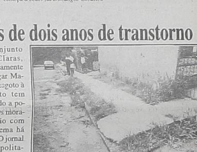
Trecho aberto para obras onde o asfalto lateral começa a ceder na Domingos Cordeiro
