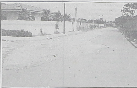
Asfalto totalmente prejudicado e sem conserto há meses no cruzamento da Antônio Jordão Guiraud e Genérico Marques
