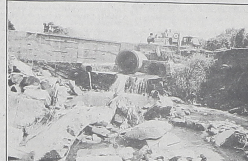
A erosão e a sujeira do Rio Pedreira
