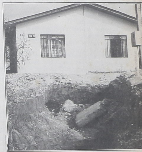
Buraco em meio a rua do conjunto, onde carros já despencaram
