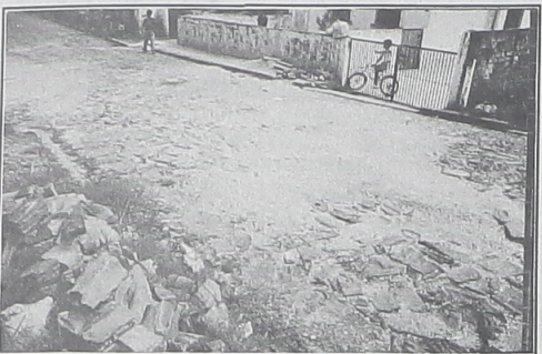
Esgoto à céu aberto é resultado de anos em que só se realizam obras paliativas
