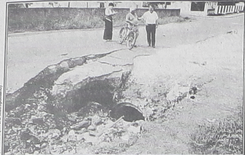
Buraco onde deveriam ser realizadas obras de manutenção
