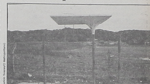
Abrigo de ônibus que está sem a maior parte de sua cobertura, não adiantando para nada
