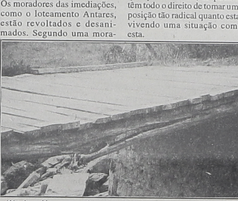
Além do problema em suas bases, a madeira da ponte está podre e já começa a ceder
