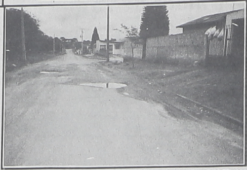
Os poucos trechos onde há asfalto estão danificados. O METROPOLITANO já fez esta denúncia há vários meses
